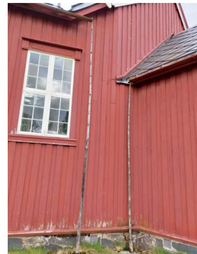
Takrenner og nedløp, og råteskadd kledning ved vassbordet.
